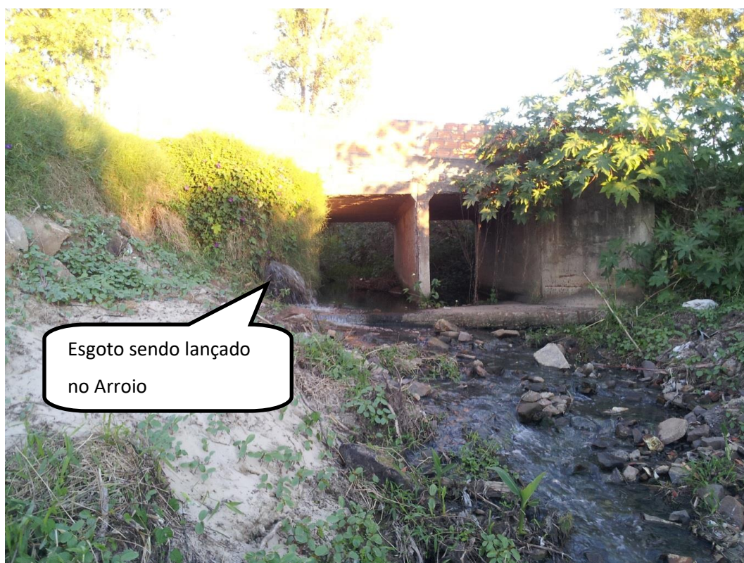
Figura 22 Lançamento de esgoto no Arroio Passal
