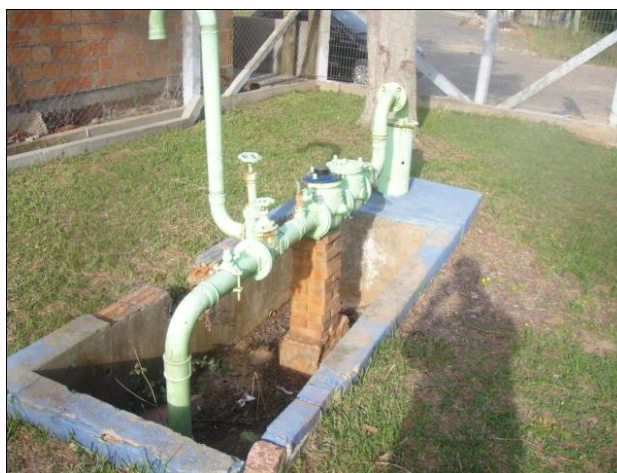
Figura 8 Poço MOST 01 A (ativo)
